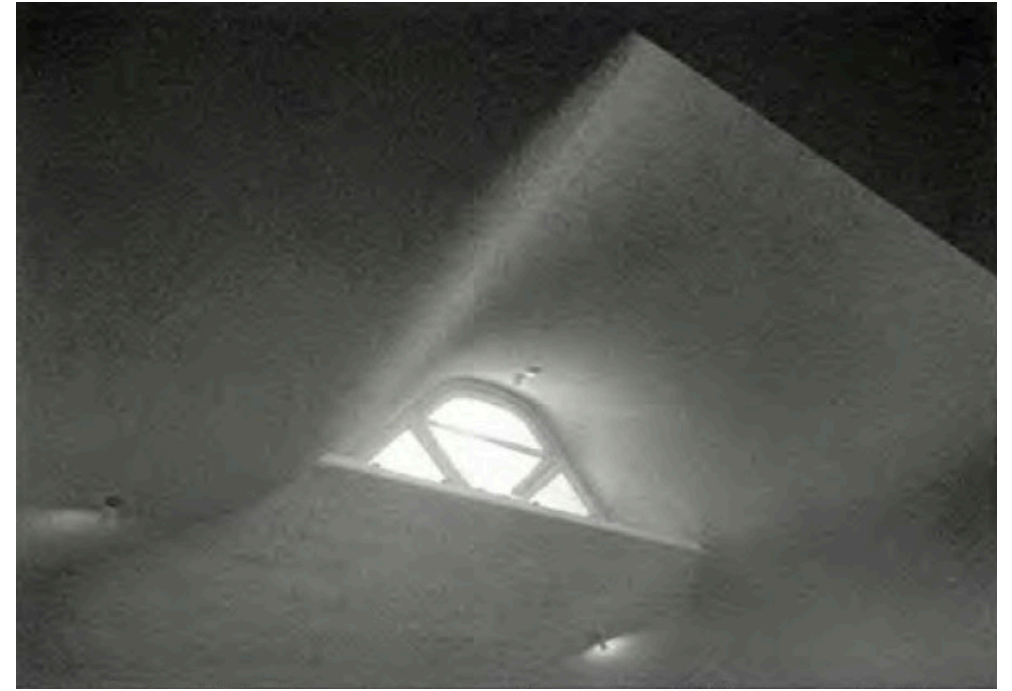
自動制御の採光・換気窓
